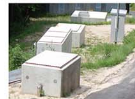
下り茅水道の浄水施設
